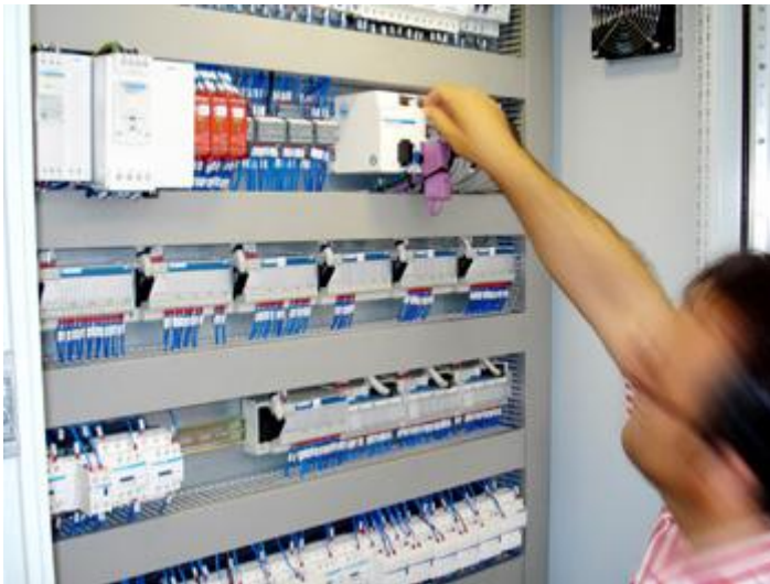
Protecciones en cuadro eléctrico
